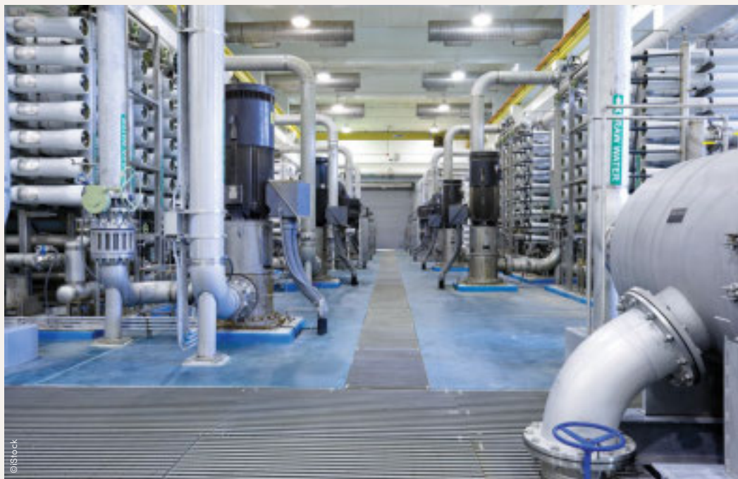
Central de dessalinização (osmose inversa)
